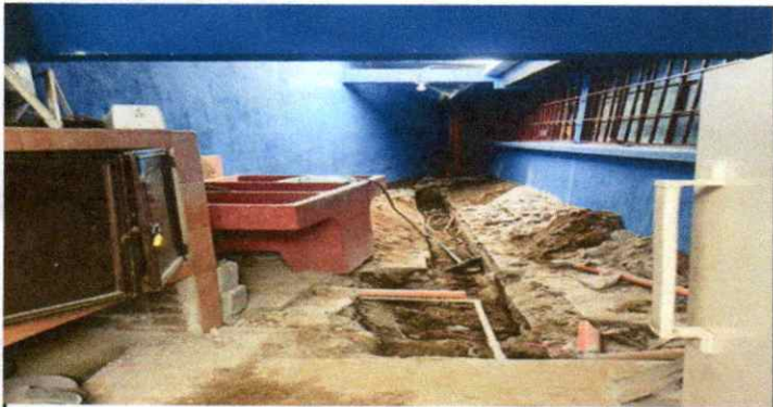
Arreglar sistema de Drenajes tapados.
