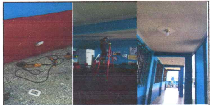
Foto 6: mantenimiento general de sistema eléctrico
