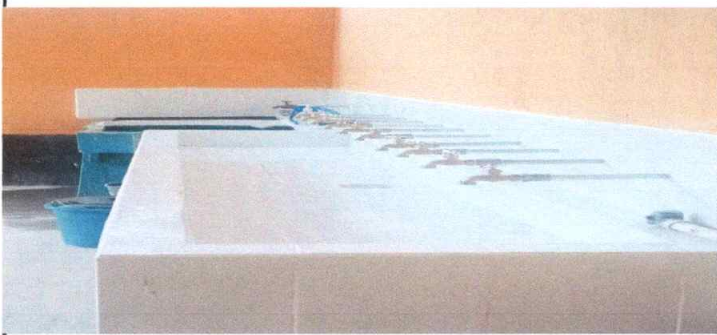
Foto 3: Lavamanos con 10 chorros
