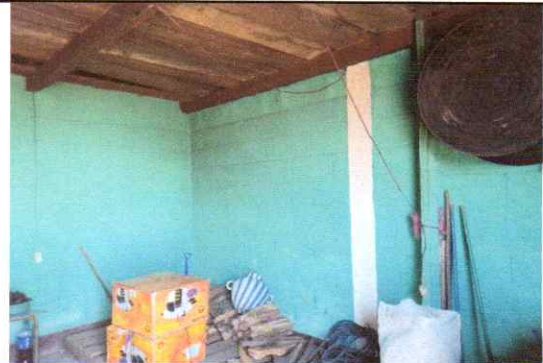
Foto 6: ESTADO DE LA COCINA
