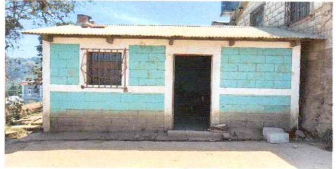
Foto 2: ESTADO DE LA COCINA ACTUAL
