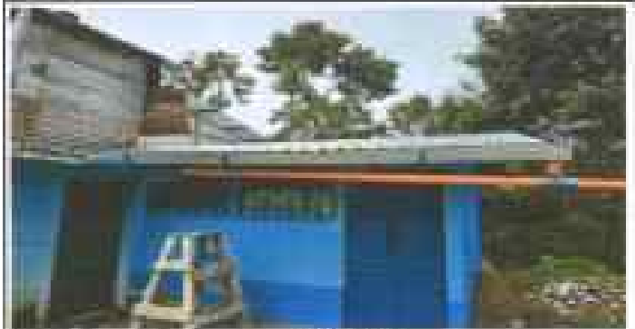
Canales para las lluvias y evitar así la filtración de agua
