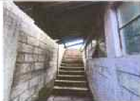
Foto 8: En el corredor se puede observar el deterioro de la estructura cobante, lo cual requiere de mantenimiento adecuado para su funcionalidad.
