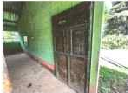
Foto 10: En aula 2, puede observarse el deterioro de puerta de metal, lo cual requiere ser reemplazada.
