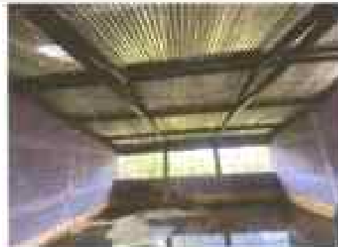
Foto 4: En el interior de las aulas se observa que la cubierta de tierra se encuentra en mal estado, provocando filtración de agua dentro del aula.
