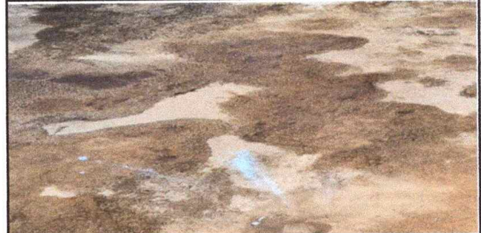
Foto 6: CONDICIONES DE LA TERRAZA ANTES DE REMOZAMIENTO.
