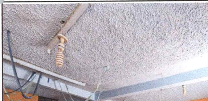
Foto 5: CONDICIONES DE LA INSTALACIÓN ELECTRICA ANTES DEL REMOZAMIENTO.
