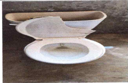
Foto 2: PREVIO AL REMOZAMIENTO CONDICIONES DE LOS SANITARIOS.
