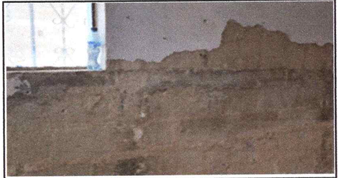
Foto 4: DESPRENDIMIENTO DEL REPELLO EN LAS PAREDES DE LAS AULAS.
