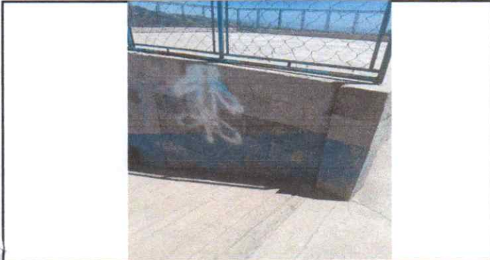
Repello de pared por filtración de agua en tiempo de lluvia
