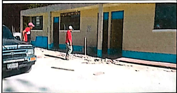
Foto 6: Sustrucción de piso de torta de concreto por piso cerámico en la parte frontal del Instituto.
