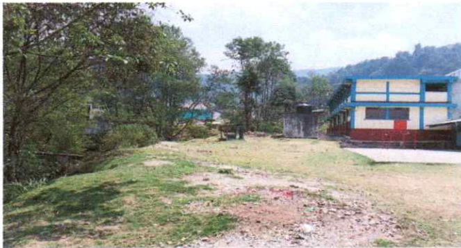
Foto 1: Lado sur del establecimiento, levantamiento de muro perimetral, con una medida de 17 metros lineales por 2.50 metros de altura.
