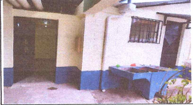
Foto 2: Describir la actividad de la fotografía: Vemos terminada la pared de la cocina y su puerta de entrada, vemos ya el piso colocado.
