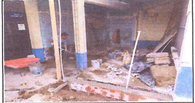
Foto 2: Describir la actividad de la fotografía: Cimientos hechos, eliminación de puerta de cocina de la primaria, cerrar con blok y abriarla de frente a la cancha.
