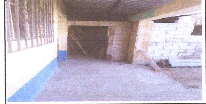
Foto 6: Describir la actividad de la fotografía: Habilitada el área para puerta de ingreso a nueva cocina y construido el muro que separará el área de cocina.
