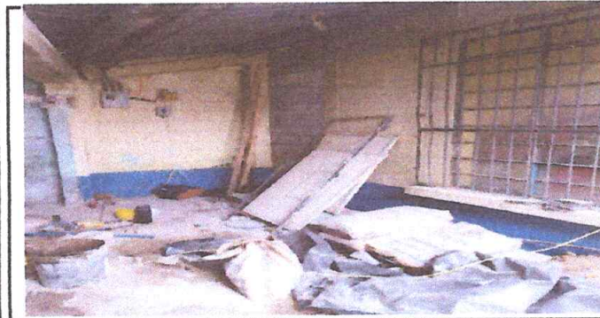
Foto 3: Describir la actividad de la fotografía: Puerta ya cerrada y abierta la otra en cocina de la primaria, se quitara ventana y se cerrara con blok.
