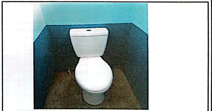
Foto 6: Colocación de un inodoro para uso de los niños y docentes terminada.
