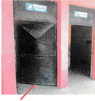
9.- MANTENIMIENTO DE PUERTA DE INGRESO (reduccion de altura y aplicación de pintura)
