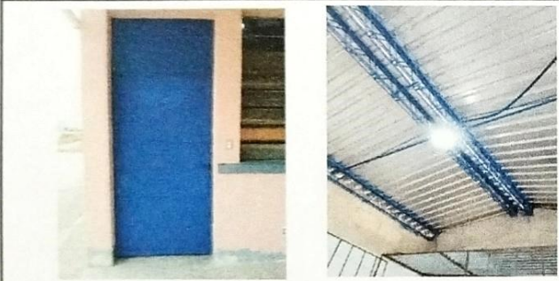
Foto 3: REPARACION DE PUERTA, REHABILITACION DE SISTEMA ELECTRICO, DEL MODULO DE SOLDADURA, AL 100%
