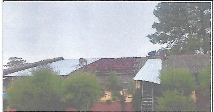
Sustitución de lámina duralita, por lámina troquelada calibre No.26 en el taller de Electricidad
