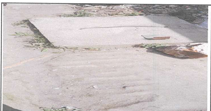
Mantenimiento de 2 poza séptica colapsado
