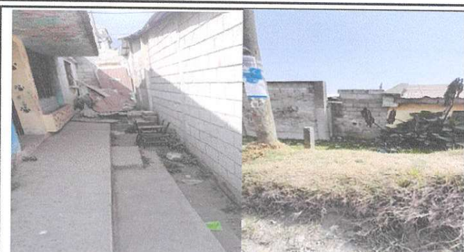
Situación: Mantenimiento de pared de block sustituir por puerta de metal y rampa de concreto que servirá para paso peatonal
