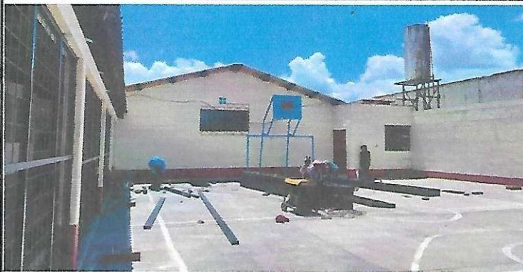
Foto 1: Corte y soldadura de perfiles para la estructura metálica. Excavación y fundición de bases.
