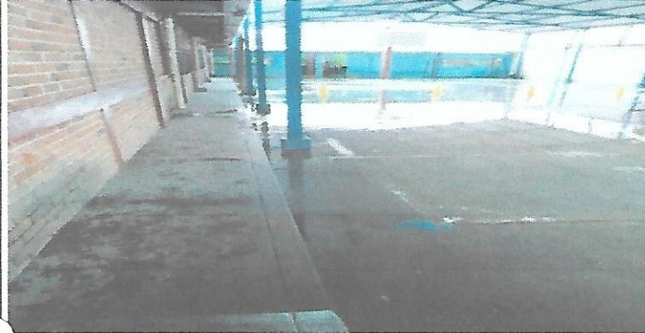
Previo: tubería de aguas pluviales superficiales, caída de agua en la cancha, agua reposada .
