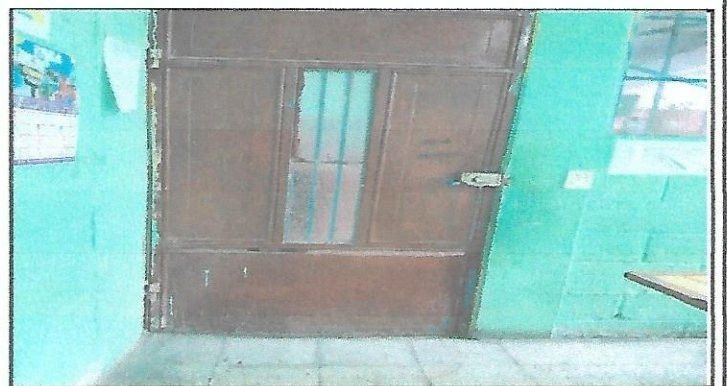
Previo: Puerta con la parte inferior abierta y oxidada.
