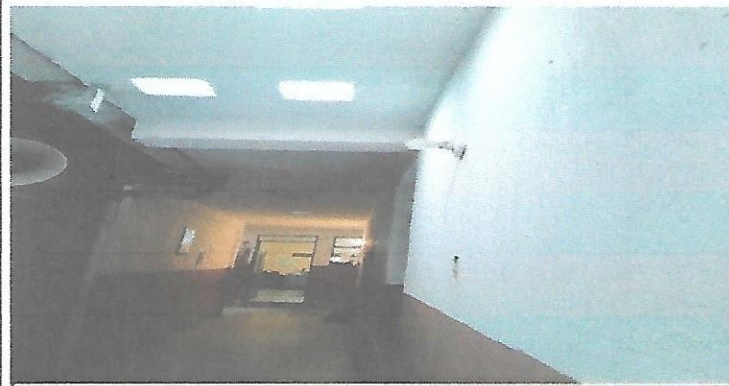
PREVIO: Pasillo sin iluminación y los focos que están inservibles.
