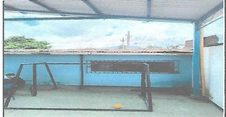
Previo: Lámina muy deteriorada por la antigüedad.
