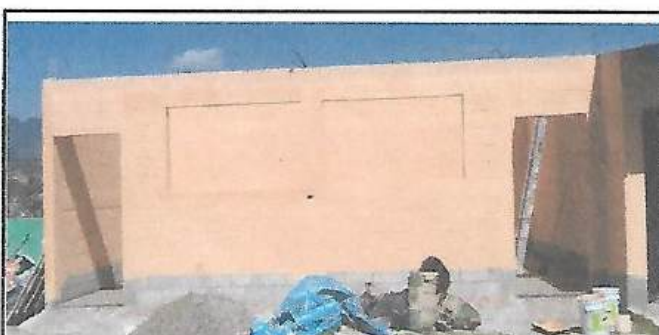
Foto 4: falta de entechado de lámina para el salón de computación
