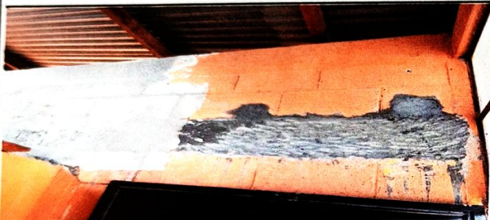
Intervención en paredes con severas rajaduras
