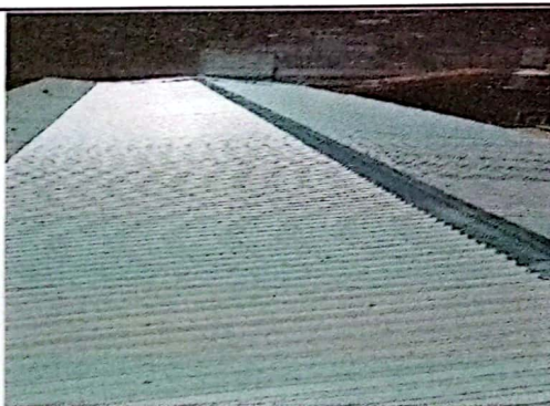
Foto 5: Vista de las dos caídas de agua instaladas
