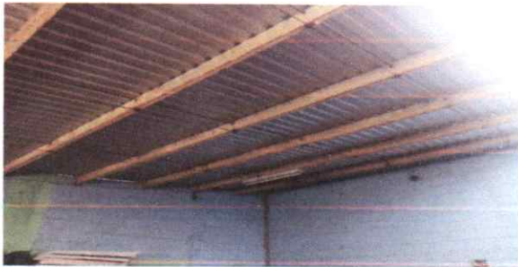
Pintura e instalación de energia electrica apropiada de salón taller de computación
