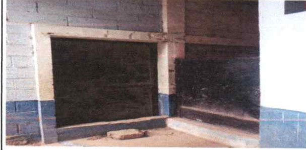
Sustituir puerta de metal (ingreso al taller de computación)
