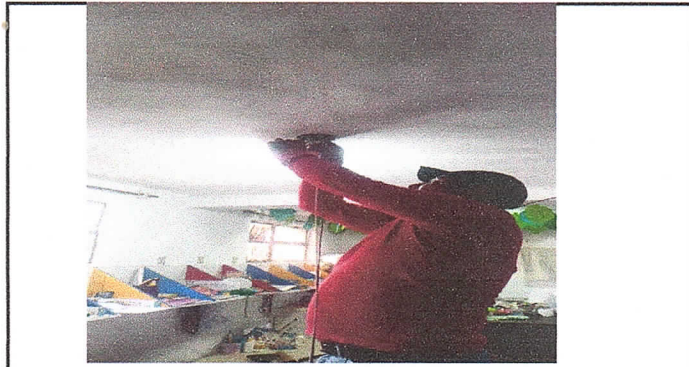
Mantenimiento de sistema eléctrico general
