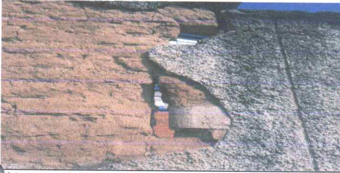
grieta muro perimetral
