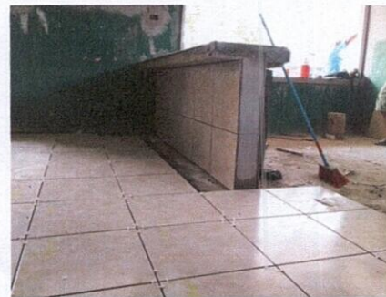
Foto 6: sustitución de piso de torta de semento por cerámico. Y reparacion de azulejos en muebles de cocina
