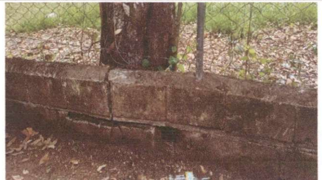
Foto 2: Reparación de Muro Perimental de Block con tubo hg y malla galvanizada soleras intermedias.
