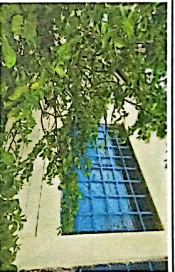
Foto 4: Sustracción de ventana de metal por vidrio
