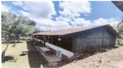
Foto 1: Sustitución de lamina, por lamina troquelada aluzinc calibre 26 modulo de aulas y direccion
