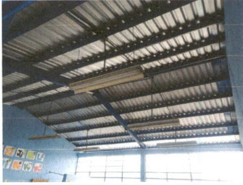
Foto1: 1.1 Sustitucion de lámina, por lámina troquelada alucin calibre 26 para dirección, aulas, bodega, baños y tribuna cívica.
