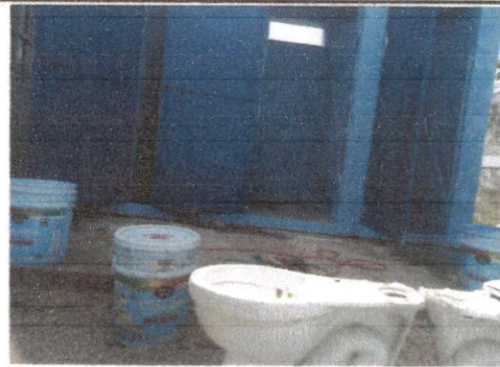
Foto 4: 10.3 Sustrucción de inodoro, 3 baños.
