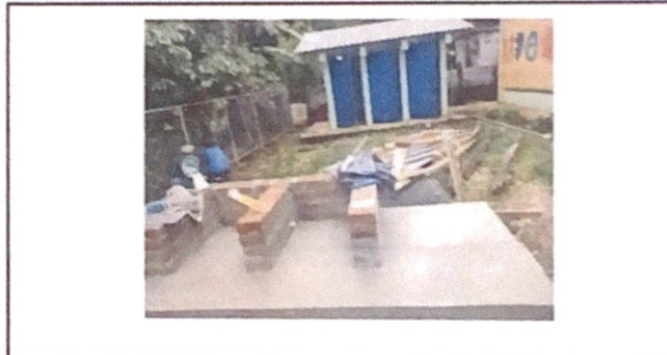
Foto 4: Sustitucion de estufa Rural
