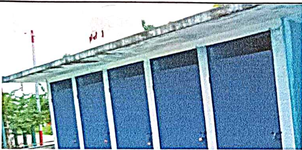
Foto 3: Mantenimiento a estructura puertas (cambio de tubo, cepillado, sujetaciones y aplicación de pintura. Baños
