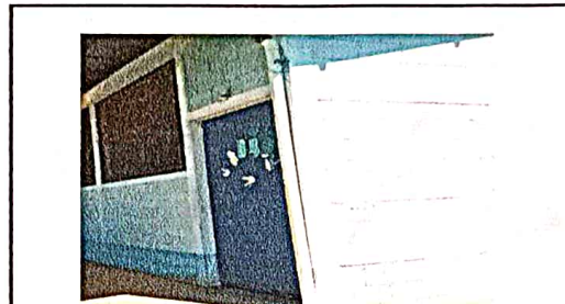
Foto 10: Mantenimiento a estructura (lijado, cambio de tubo , cepillado, sujeciones, aplicación de pintura) aulas
