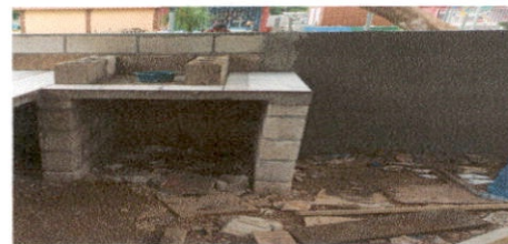
Foto 6: Mantenimiento a estufa rural
