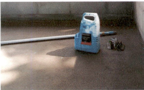
Foto 3: Sustrucción de piso de torta de concreto
