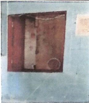
Foto 3: Ventana a remozar
