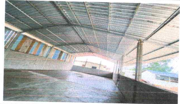
Piso liso, lamina troquelada aluzinc calibre 26 y estructura portante de metal
