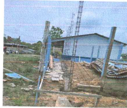
Construcción de cimiento y colocación de varilla para columnas de concreto, porque la anterior construcción carecía de ambas cosas
