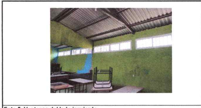
Foto 5: Ventanas del lado izquierdo.
