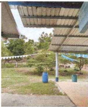
Foto 5: Lámina y estructura dañada
