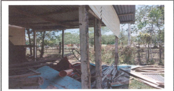
Foto 4: Escombros de la bodega
