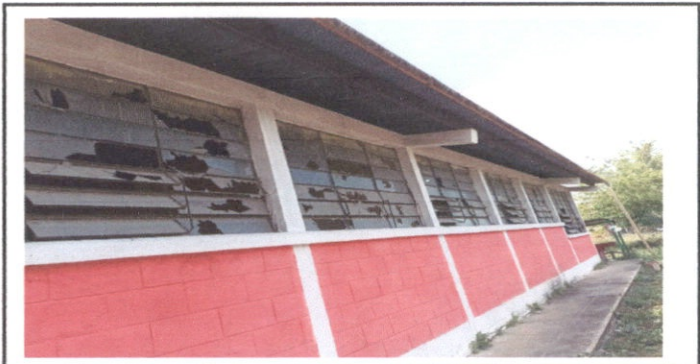
Foto 6: Se retiraran los vidrios rotos
