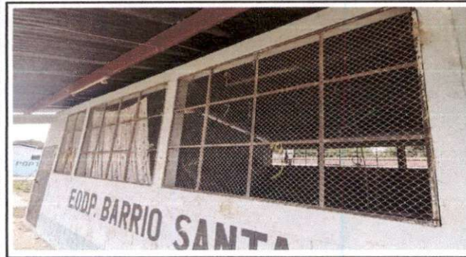
Foto 3: Sustitución de estructura de metal de ventanas, sustitución de vidrios, sustitución de 2 puertas de metal (de una aula y cocina), mantenimiento a estructura de dos puertas de aulas (lijado y pintura). ✓
