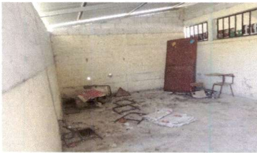
Foto 5: Sustrucción de piso de torta de concreto
