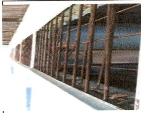
Foto 4: RESTAURACION DE BALCONES DE METAL EN MAL ESTADO
