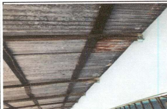
Foto 5: ESTRUCTURA DE MADERA EN MAL ESTADO
