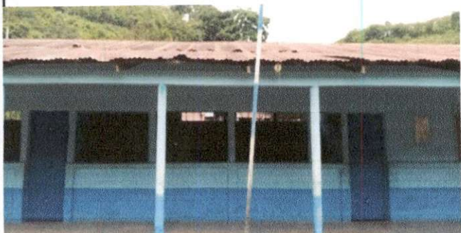
Foto1: TECHO Y ESTRUCTURA DE MADERA DEL AULA DE QUINTO Y SEXTO GRADO EN MAL ESTADO
