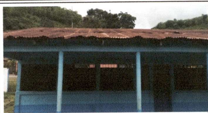
TECHO DEL AULA DE CUARTO GRADO EN MAL ESTADO
