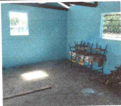
Foto 5: Repello y muro
