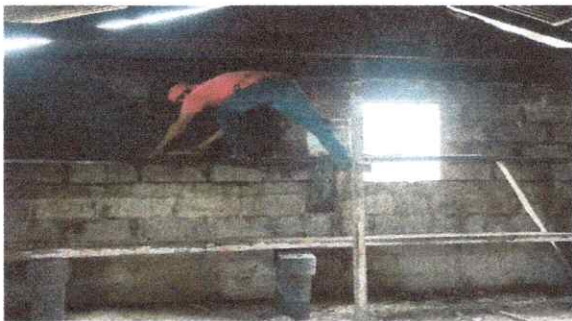
Foto 5: Repello y muro
