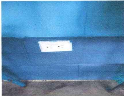
Foto 3: toma corriente nuevos
