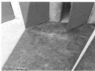
Foto 5: Piso en la parte de afuera
