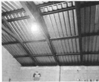
Foto 3: Focos ahorradores funcionando a la perfección
