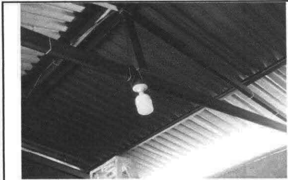
Foto1: Focos ahorradores instalados
