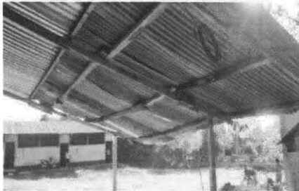
Foto 1: Galera en mal estado.
