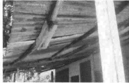
Foto 2: Vigas a punto de quebrarse.
