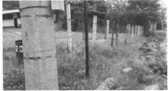
Foto 2: Postes en mal estado
