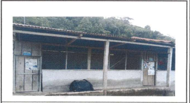
Foto 4: Sustitución de lámina, por lámina troquelada aluzinc calibre 26 Sustitución de elementos de fijación en cubierta de lámina
