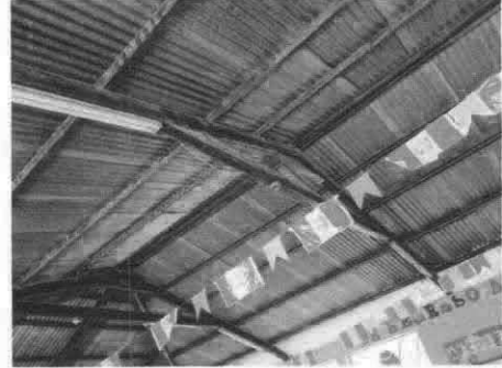
Foto 2: Lámina y estructura dañadas
