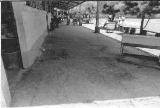
Foto 5: Piso del Corredor en mal estado
