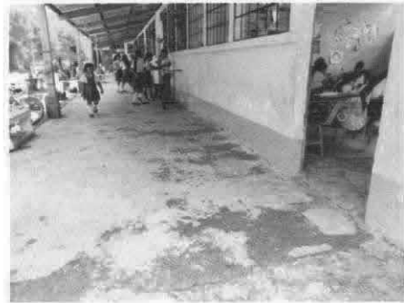
Foto 6: Piso del corredor en mal estado
