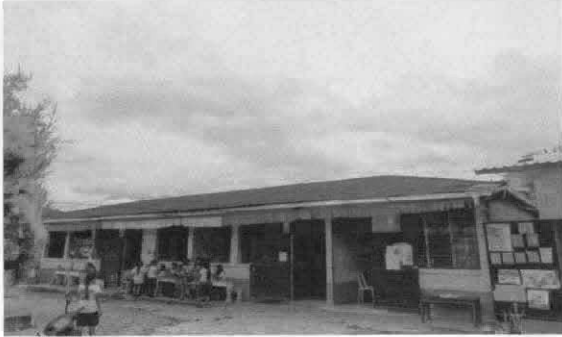
Foto1: Lámina y estructura dañanas
