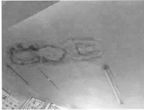
Foto 3: Filtración del agua en terresa
