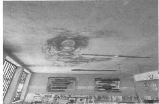
Foto 4: Filtración del agua en terraza
